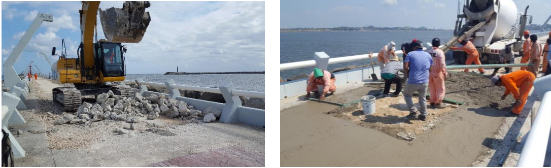
Figura 23 y 24. Remoción del material de demolición de la calzada de la escollera y suministro de concreto en la misma.
