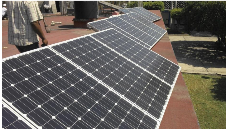
Figura 2.- Arreglo físico de los paneles fotovoltaicos.
