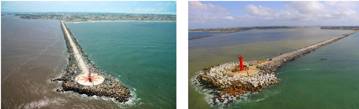
Figura 25 y 26. Escollera de Coatzacoalcos antes de su rehabilitación con severos daños y después de la reparación de la misma.
